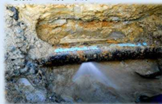
▼老朽化による漏水の状況
