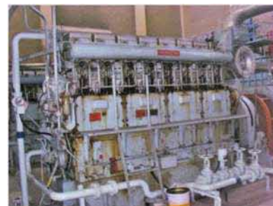
ポンプ用エンジン
