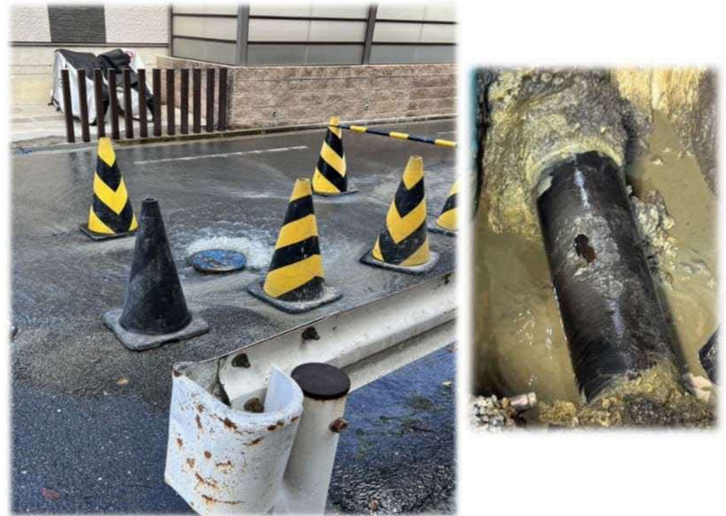
▼老朽化による漏水の状況
