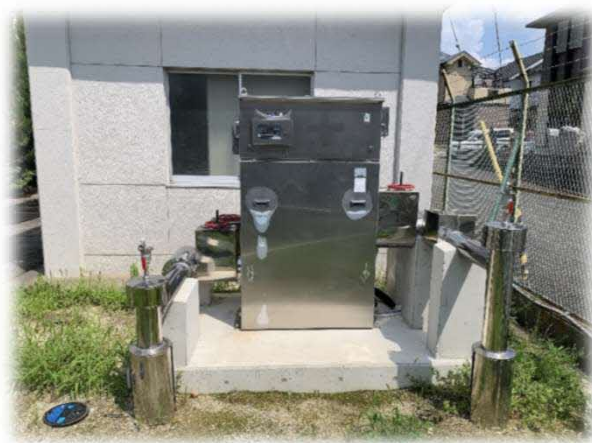
—楠葉配水場の加圧ポンプ—
