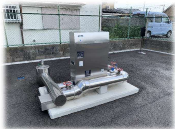
—東香里加圧ポンプ場の加圧ポンプ—
