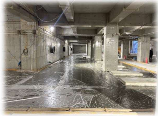
—膜ろ過棟地下1F ポンプ室—
