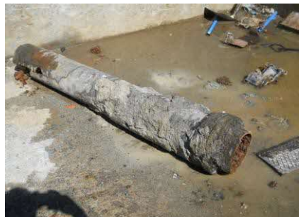
漏水により撤去した水道管
