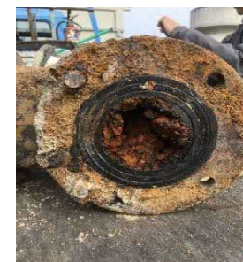
錆により詰まった老朽管
