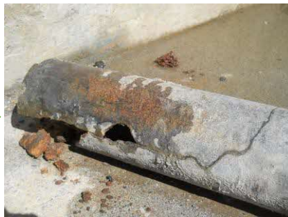
拡大写真 (ひび割れ)
