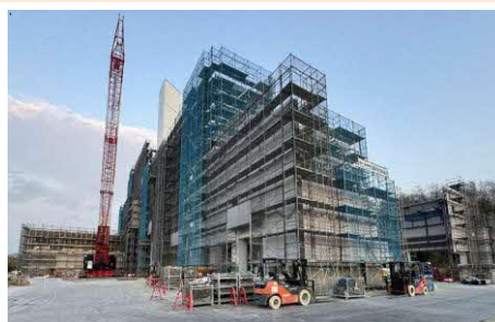
可燃ごみ広域処理施設
