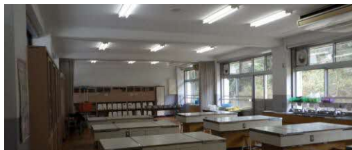
照明器具のLED化
