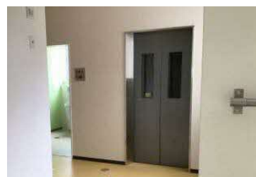
学校エレベーター
