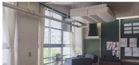
省エネ性能に優れた空調設備
