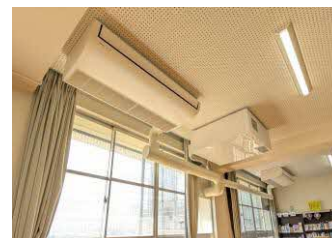
教室等空調設備
