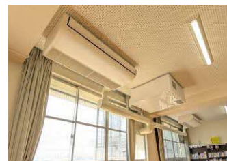
教室等空調設備
