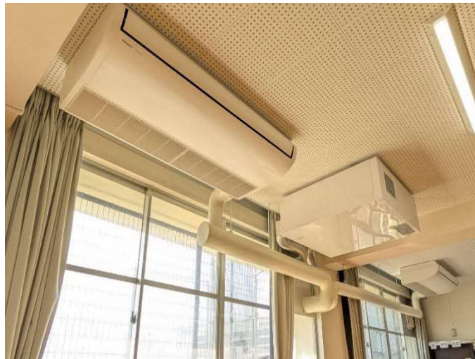
■室内機、全熱交換器の設置状況
