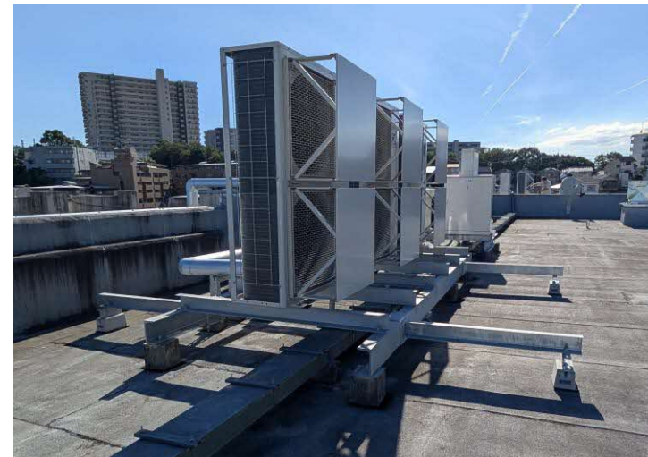
■室外機の設置状況（屋上）
