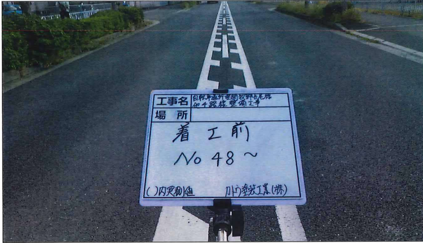
写真区分: 着工前及び完成写真(道路) 写真タイトル: 着工前 撮影箇所: No48~
