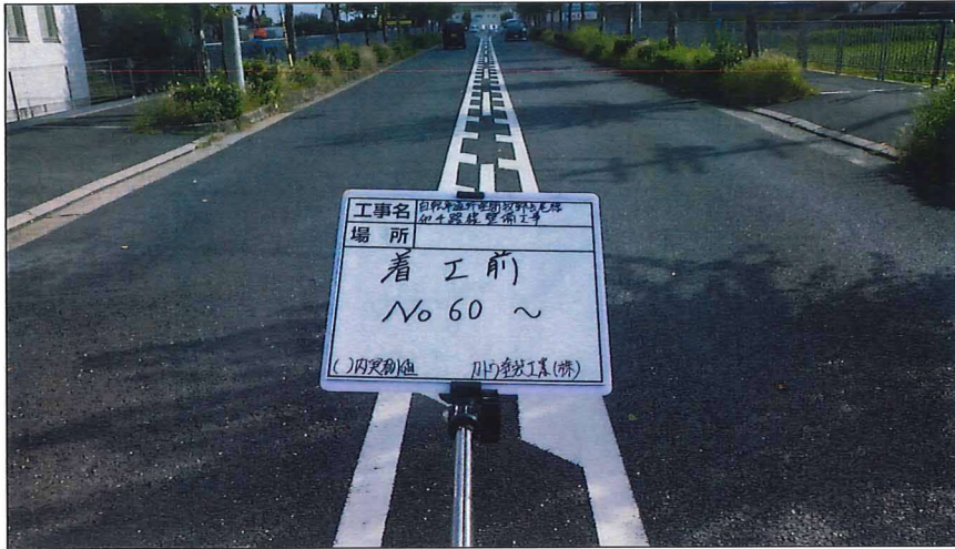
写真区分: 着工前及び完成写真(道路) 写真タイトル: 着工前 撮影箇所: No60~
