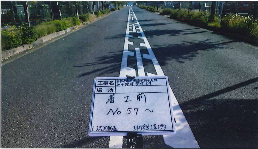
写真区分: 着工前及び完成写真(道路) 写真タイトル: 着工前 撮影箇所: No57~
