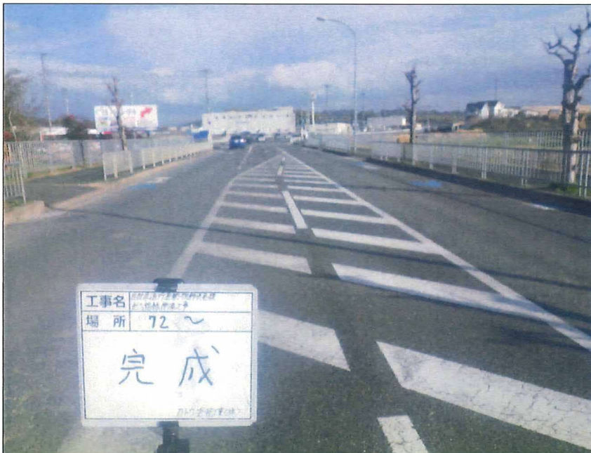
写真区分: 着工前及び完成写真(道路) 写真タイトル: 完成 撮影箇所: No72~
