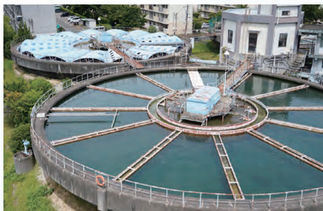
▲水の濁りを塊にして取り除く凝集沈殿池
