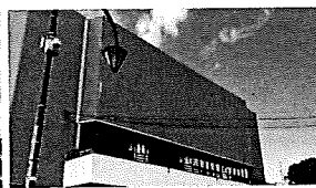
タイル落下防止ネットで覆われた市民会館大ホール
