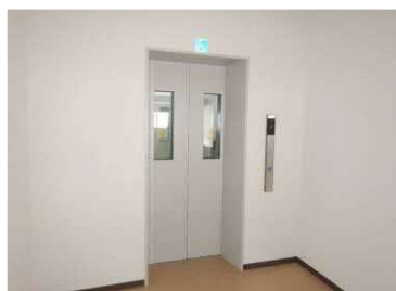
学校エレベーター
