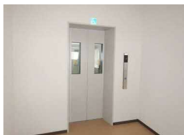
学校エレベーター
