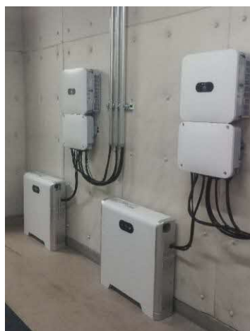
太陽光発電設備のうち蓄電池 の設置状況（地下1階電気室）
