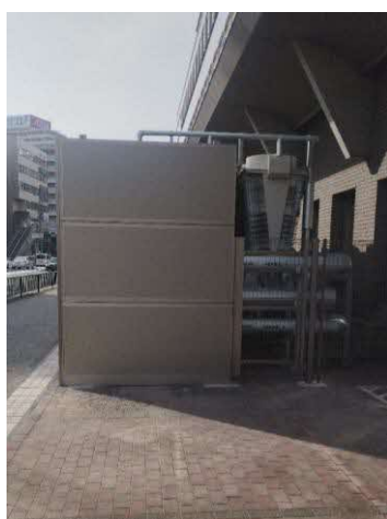
空冷ヒートポンプチラー の設置状況（建物南側外部）
