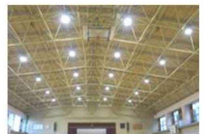
LED照明設備
