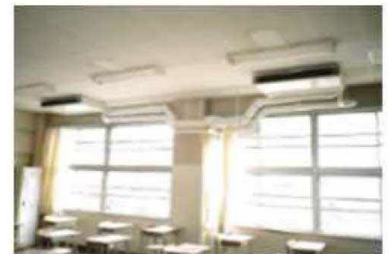
教室空調設備
