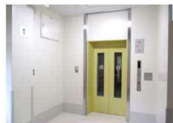
エレベーター
