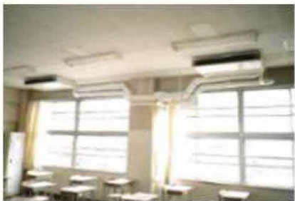
教室空調設備
