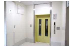
エレベーター
