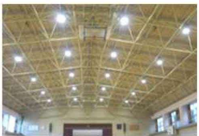
LED照明設備
