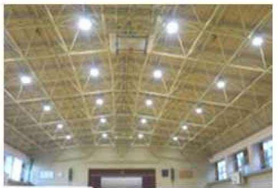
LED照明設備
