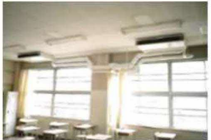
教室空調設備
