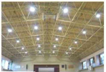
LED照明設備
