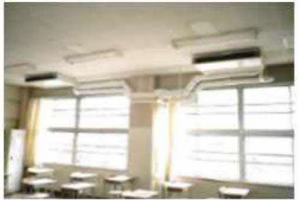
教室空調設備
