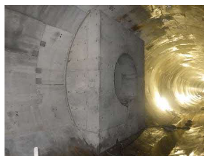
<地下での流入管の接続>
