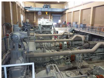
<北部ポンプ場内部>
