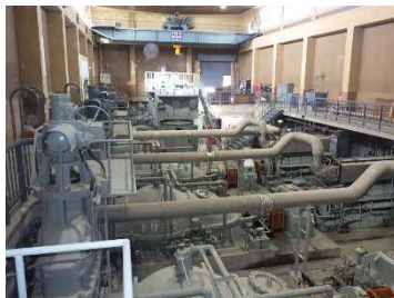
<北部ポンプ場内部>
