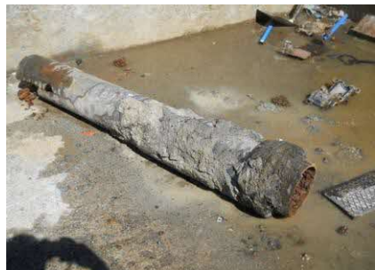
漏水により撤去した水道管
