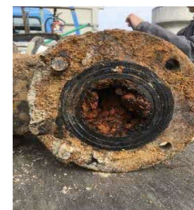
錆により詰まった老朽管
