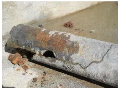
拡大写真 (ひび割れ)
