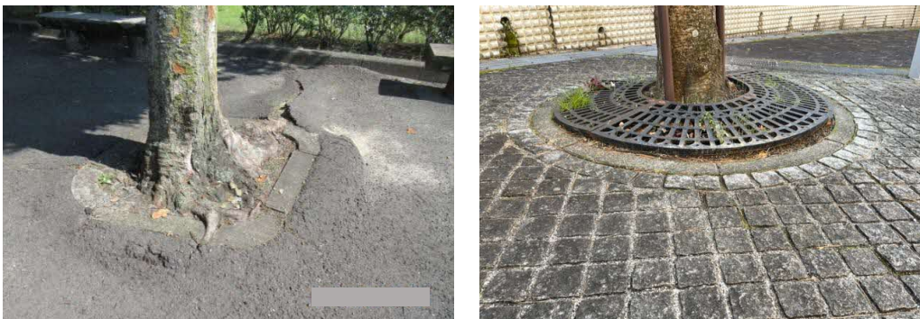
写真5 根上がりにより舗装や保護蓋の段差が生じた事例
