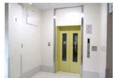
エレベーター
