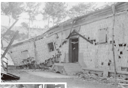
▲ 爆発で崩れた禁野火薬庫倉庫
