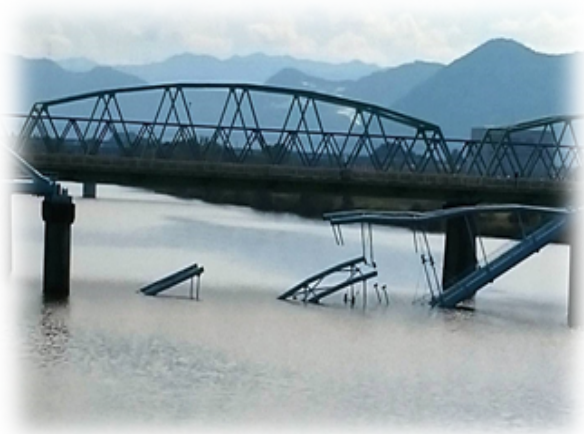
(和歌山市水管橋崩落事故の様子)
