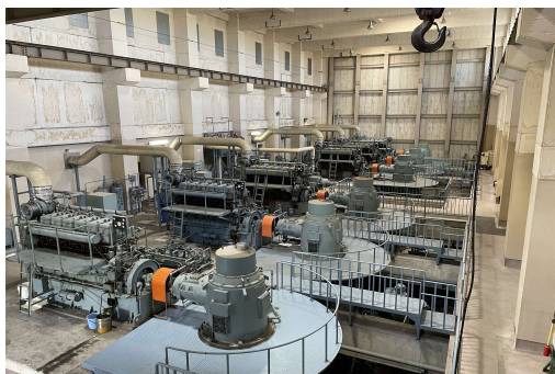
<蹠躰ポンプ場内部>
