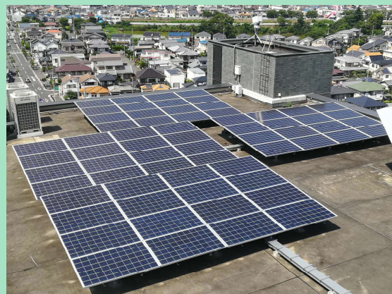
太陽光パネル 21.2kw（きらら屋上）
