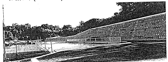
整備工事が進む御殿山小倉線（写真は浄水場側 12月10日撮影）
