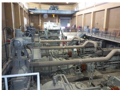
＜北部ポンプ場内部＞
