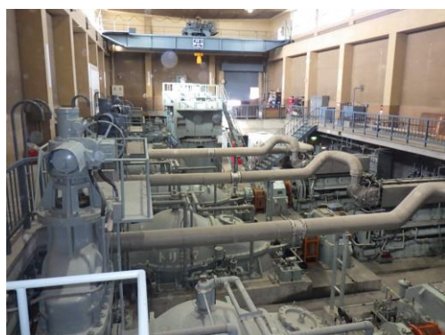
<北部ポンプ場内部>
