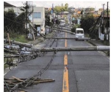
写真 2-1 泉南市道（泉南市） （出典：大阪府無電柱化推進計画）
