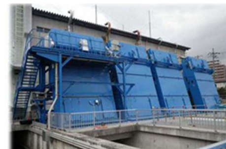
沈砂池設備（除塵設備）
