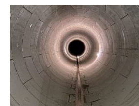
蹠跚雨水貯留管
