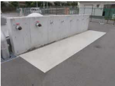
3号池応急給水栓 災害時に応急的に利用できる給水栓です。
