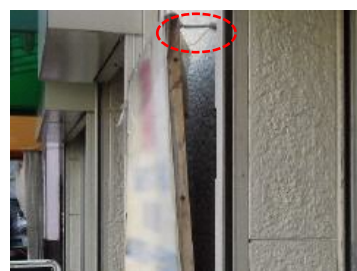
取付対象部・取付部周辺の異常
