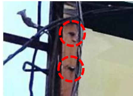
鉄骨接合部（ボルト）のゆるみ
