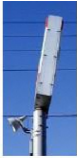
上部構造全体の傾斜・ぐらつき
