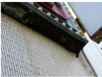
取付部プレートの腐食・変形
