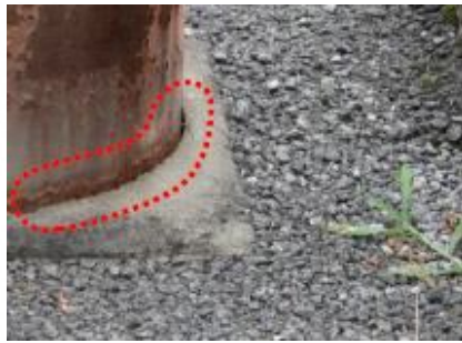
支柱と根巻きとの隙間
