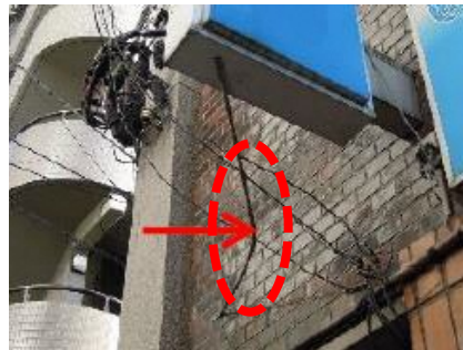
付属部材(振れ止め棒)の破損
