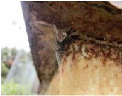
鉄骨接合部の腐食、変形、隙間
