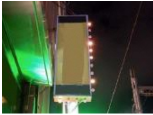
照明装置の不点灯
