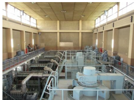
<北部ポンプ場内部>
