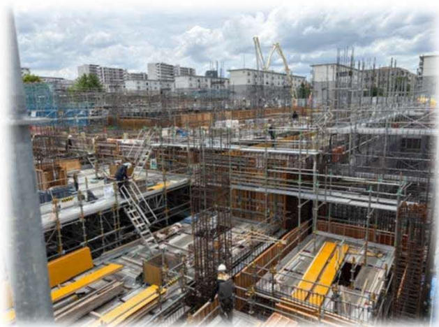
くうきそうしつ — 膜ろ過棟（空気槽室） —
