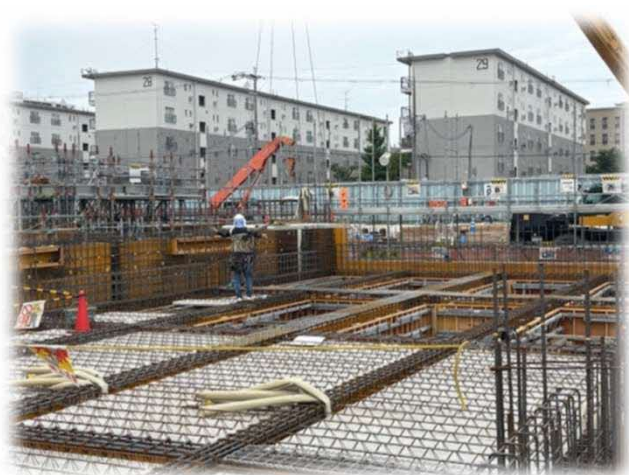
— 膜ろ過棟（配管室） —
