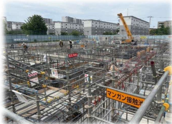
せつしょくち — 前処理施設（マンガン接触池） —
