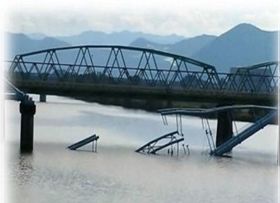
（和歌山市水管橋崩落事故の様子）
