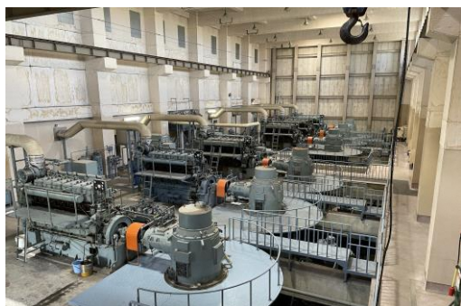
<蹠跎ポンプ場内部>
