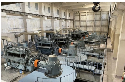
<蹠跢ポンプ場内部>
