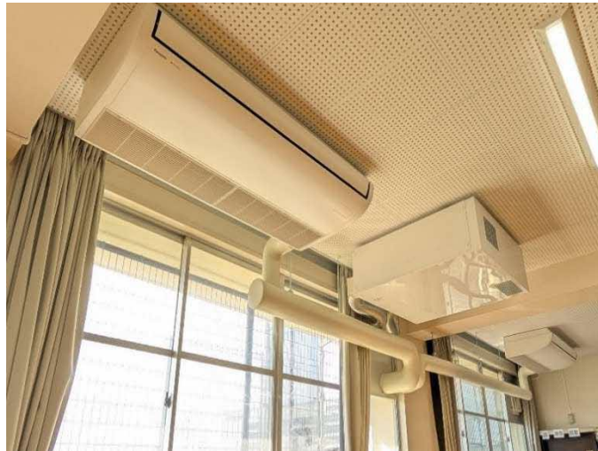
■室内機、全熱交換器の設置状況
