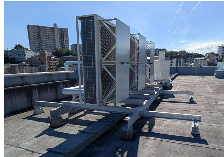
■室外機の設置状況（屋上）
