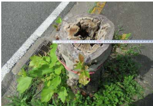
写真14 空洞ができた街路樹の事例
