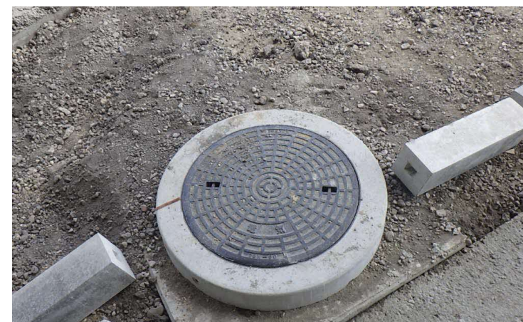
街路灯の地中配管及びハンドホール
