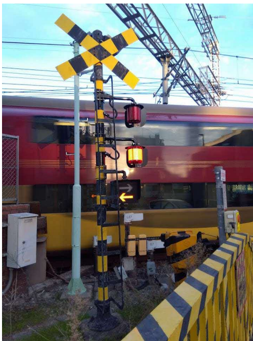
牧野踏切道（更新後）
