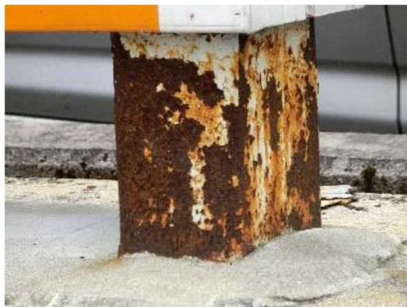
支柱根元の腐食が進行した状態
