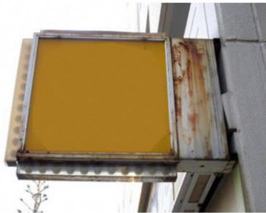
ブラケットカバーにさびが進行した状態
