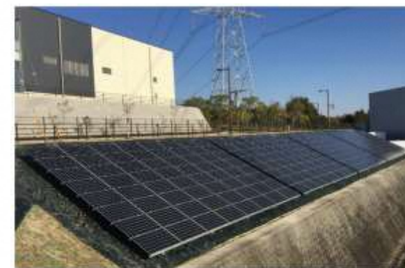
生駒市民共同発電所4号機 (学研高山地区市道南法面/先端大北側)
