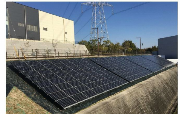
生駒市民共同発電所4号機 (学研高山地区市道南法面/先端大北側)
