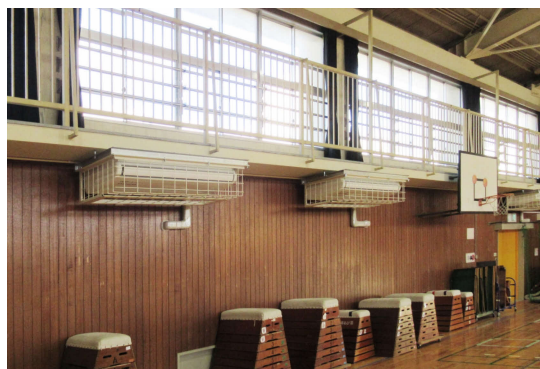
体育館の空調設備がこの夏に完備
