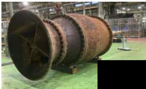
ポンプ分解・点検前
