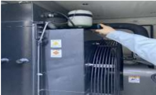
非常用発電機の燃料等の残量確認・試運転等
