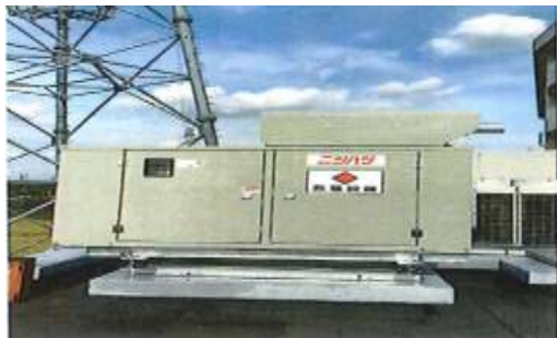
高齢者施設の非常用自家発電設備の整備
