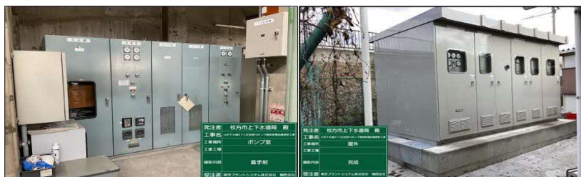
(写真) 安居川ポンプ場受変電設備工事前 (写真) 安居川ポンプ場受変電設備工事後
