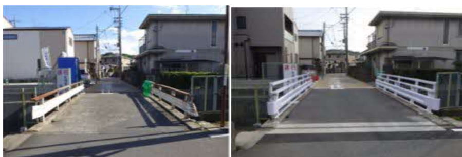
（写真）橋梁修繕前（無名 58 号橋）
