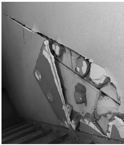
大阪北部地震で被害を受けた市庁舎（土木部中部別館）
